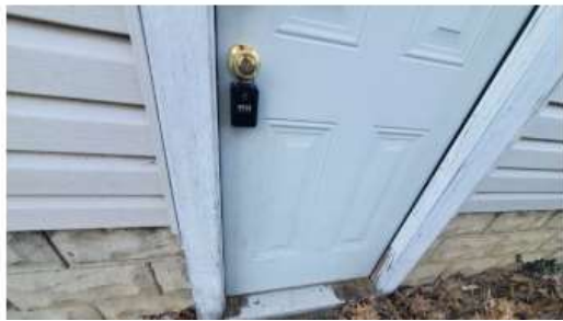
Peeling Paint - Exterior Frame Door
